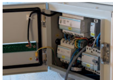
Véritable tableau de distribution électrique
